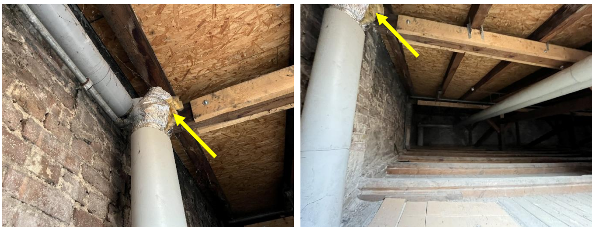
Abbildung 5: Rohrummantelungen im Dachstuhl der Turnhalle enthalten eine gelbe Mineralwolle.
